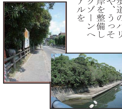
手入れされていないうっそうとした護岸や段差のある歩道。現状をあらためて調査し、検討へ
